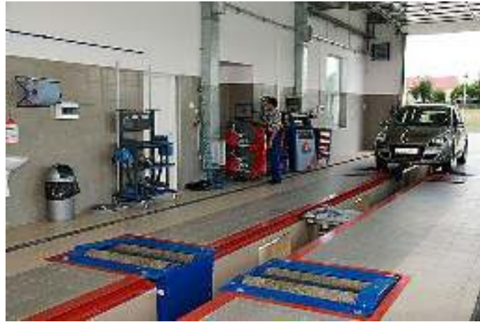
Rysunek 6 Przykładowy układ wyposażenia na stacji kontroli pojazdów
